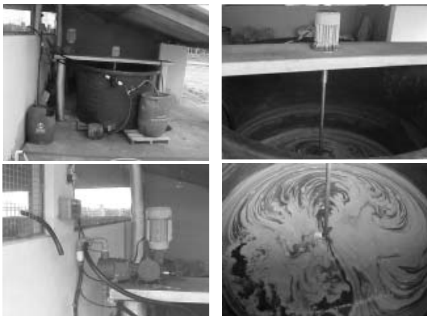
Figura 12 - Sistema de injeção de fertilizante com bomba de injeção direta e pá misturadora de acionamento elétrico (Foto: Fazenda FAHMA – L29M/C2 – Projeto Jaíba).
